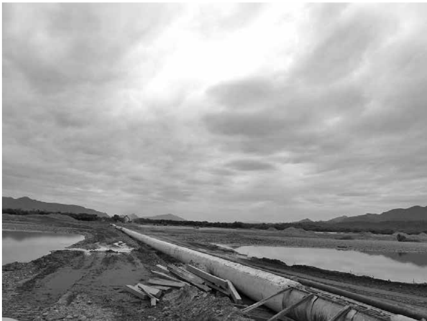
Figura 19: Un nuevo gasoducto requiere la desviación del río Pilcomayo (octubre 2011, foto de la autora)
